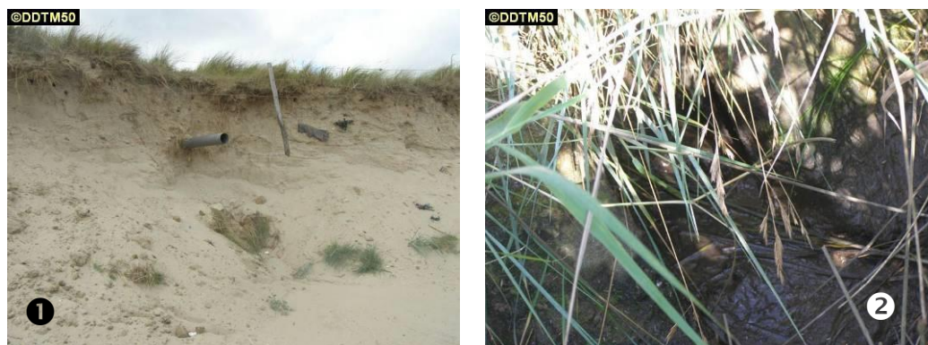
Figure 26 : Vues sur les quelques exutoires pluviaux présents sur le littoral de la zone d'étude
