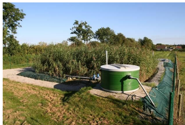
Figure 29 : Vue sur les filtres plantés de roseaux du bourg de Turqueville- Photos du PNR MCB
