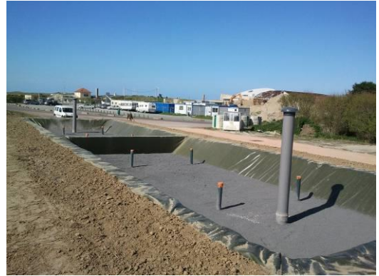
Figure 31 : Vue sur le dispositif d'assainissement du Musée d'Utah Beach lors de son installation- Photos du PNR MCB
